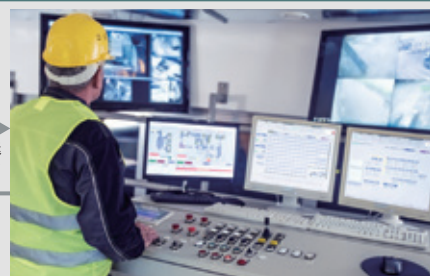
制御室 Control room
